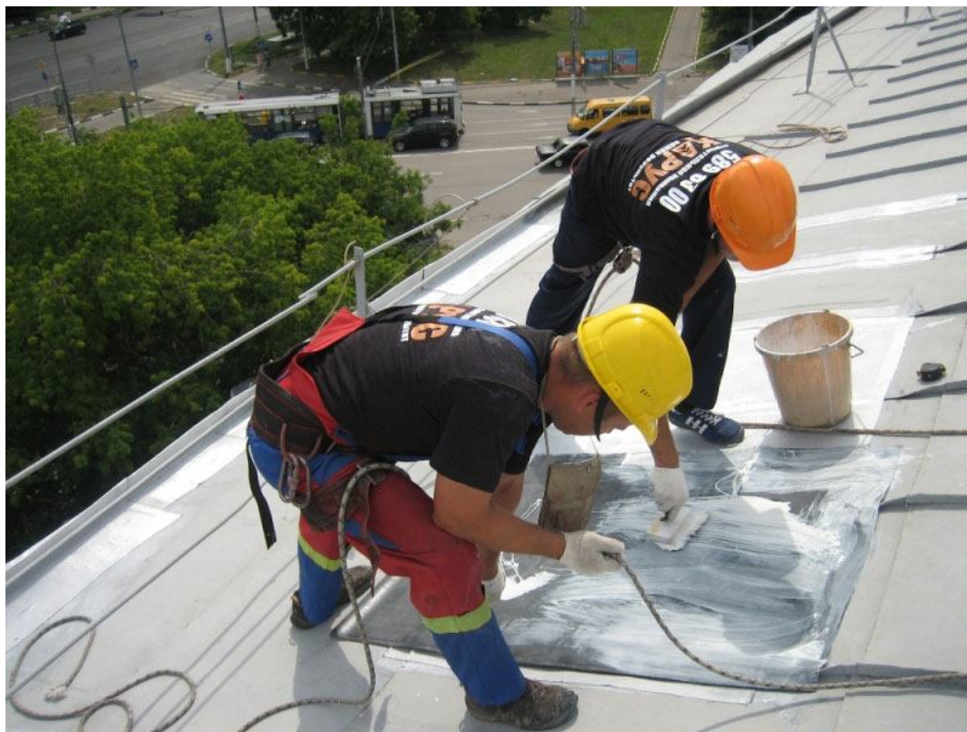
Рисунок 4.1 – Ремонт окремих пошкоджень покрівель
