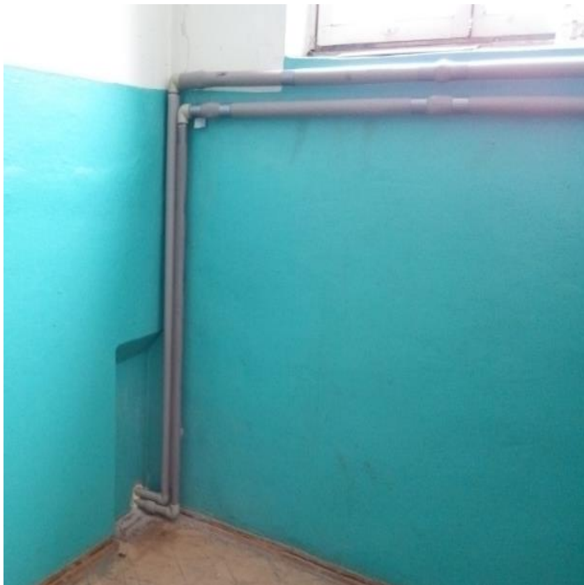
Рисунок 5.5 – Фрагмент прокладки горизонтальних трубопроводів системи опалення в сходових клітках
