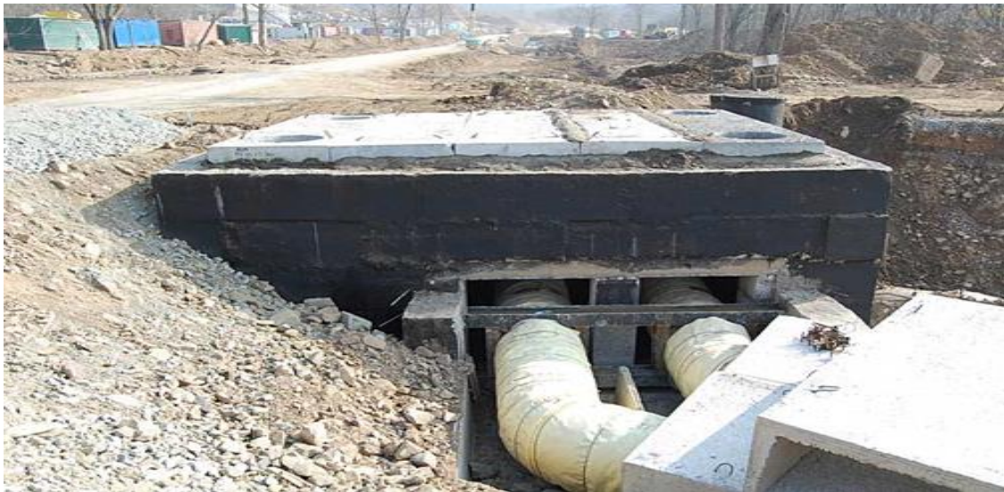
Рисунок 7.37 – Фрагмент підземної теплової камери в ґрунті
