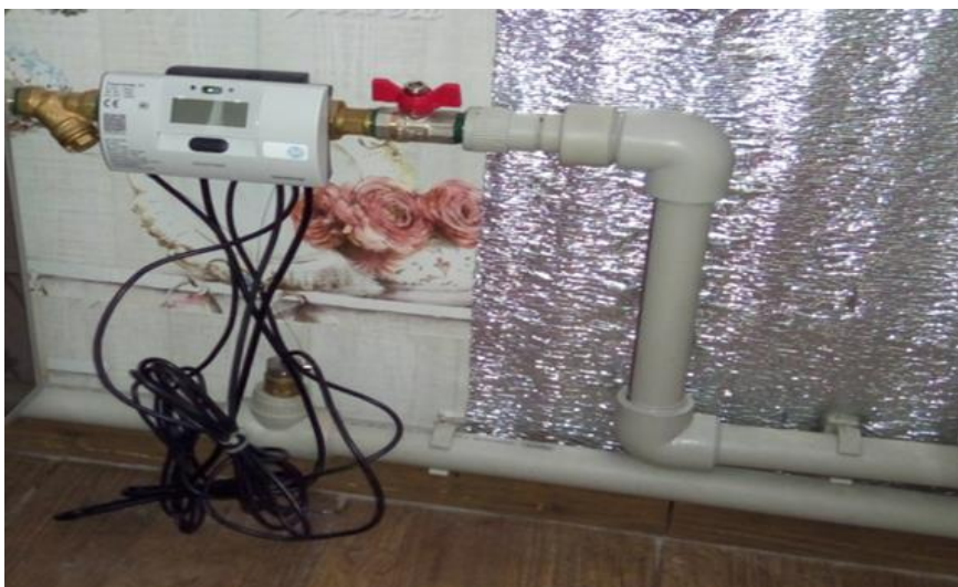
Рисунок 5.7 – Фрагмент установки квартирного лічильника тепла
