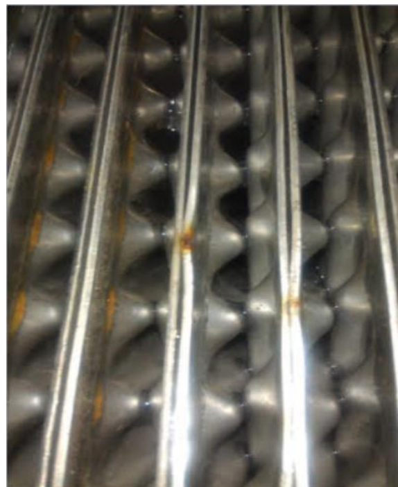
Рисунок 13.10 – Брудний канал після механічного очищення
