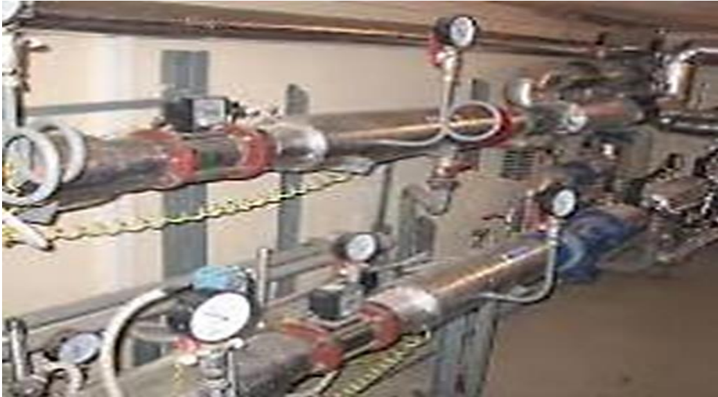
Рисунок 3.2 – Фото вузла обліку тепла на теплорозподільчій станції [URL: https://termoprom.com.ua/uk/poslugi/servis/servis-uzlov-ucheta-tepla .]
