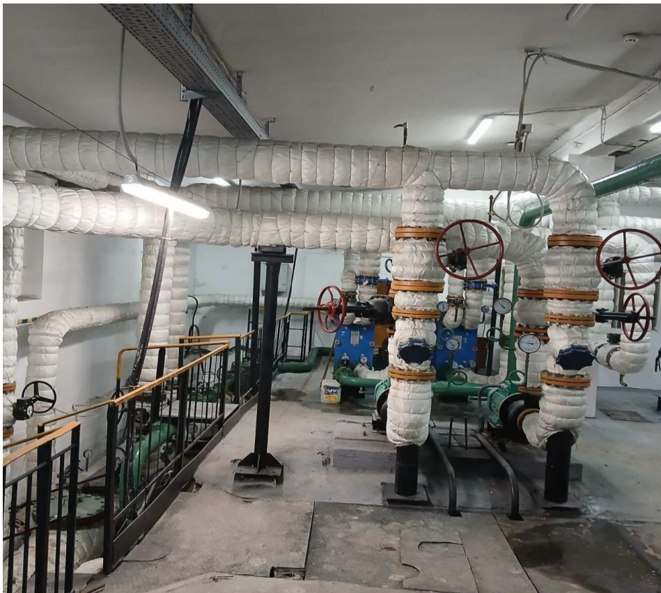
Рисунок 8.9 – Підмішуючі насоси системи опалення
