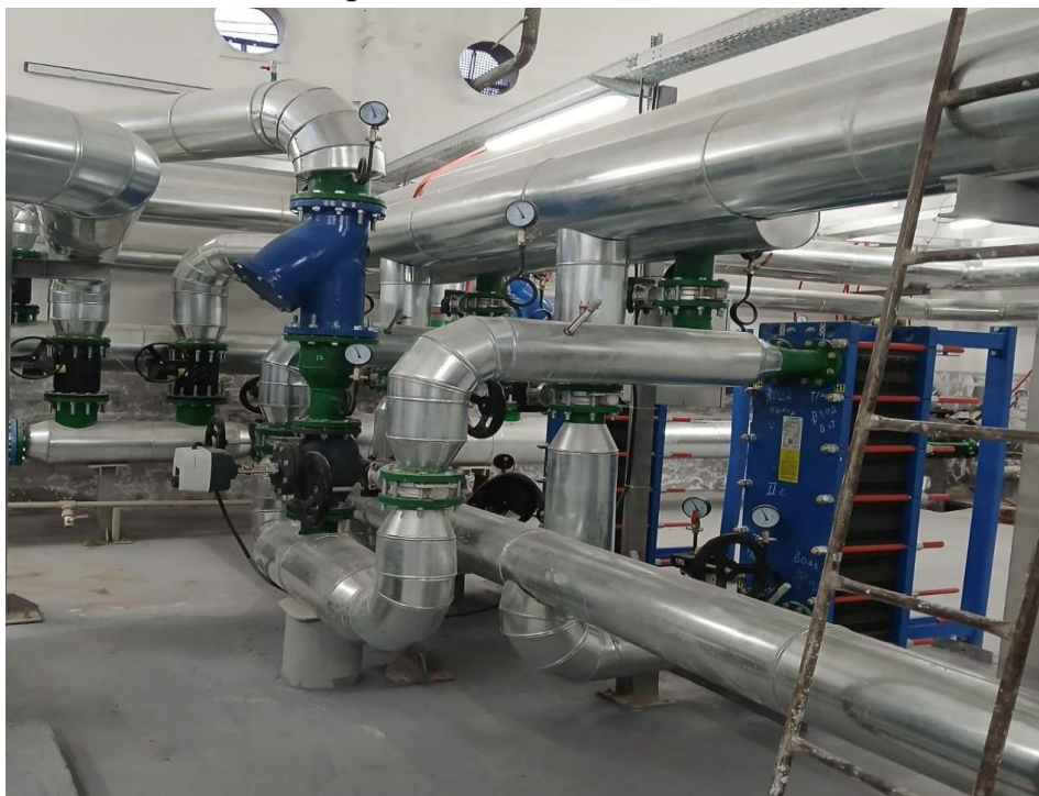
Рисунок 8.13 – Пластинчасті теплообмінники системи гарячого водопостачання на ТРС з обв'язкою трубопроводами
