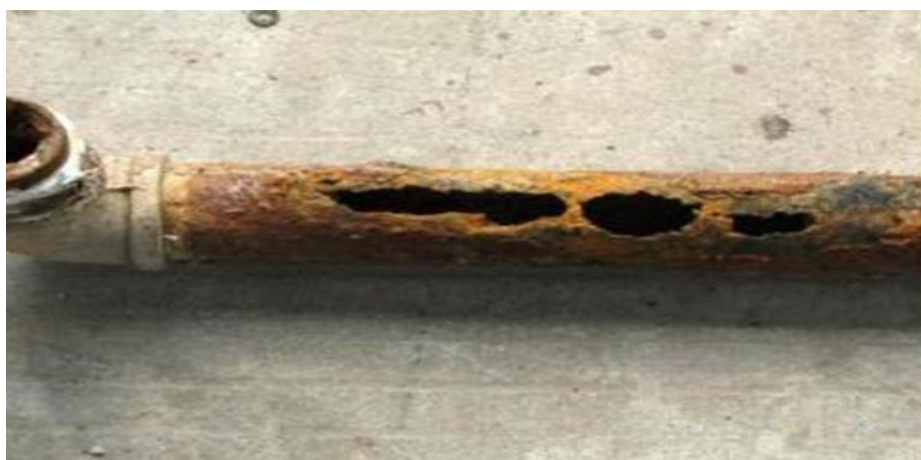
Рисунок 12.7 – Трубопровід гарячого водопостачання після 4 років експлуатації
