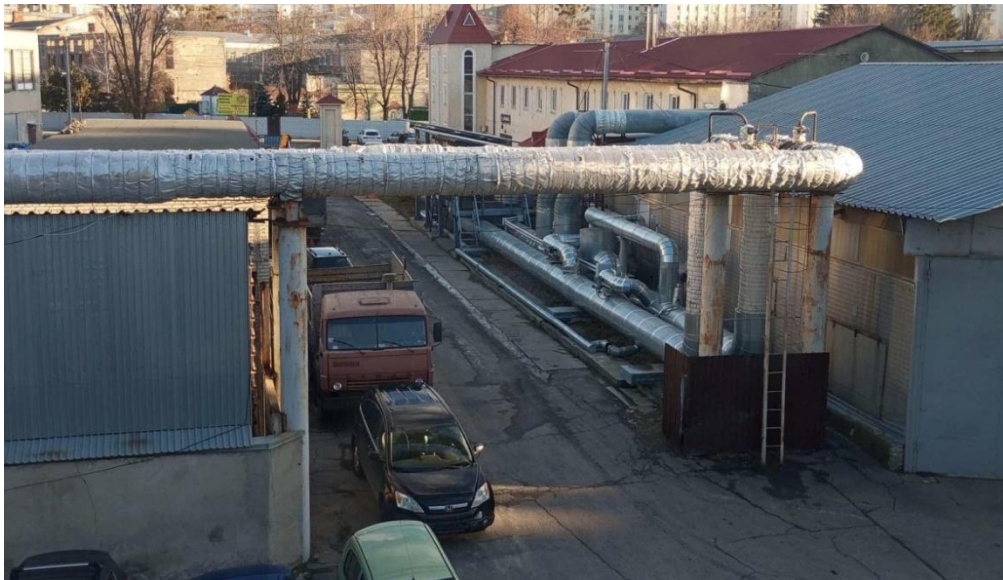
Рисунок 7.19 – Надземна прокладка теплотраси над проїздами в промзоні. Справа показаний вузол підключення абонента
