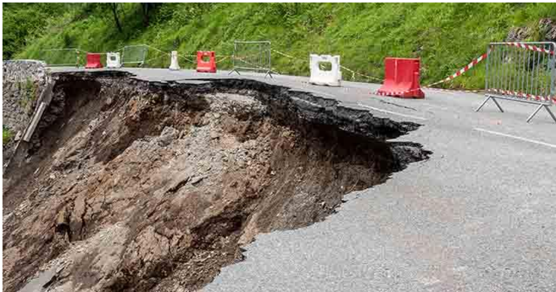
Рисунок 1.4 – Приклад зсувного процесу з пошкодженням конструкції проїжджої частини
