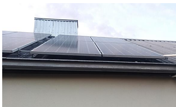
б) фотоелектричні панелі на даху будинку
