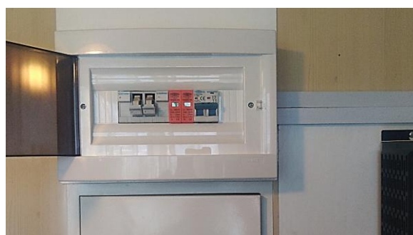
в) блок захисту електростанції
