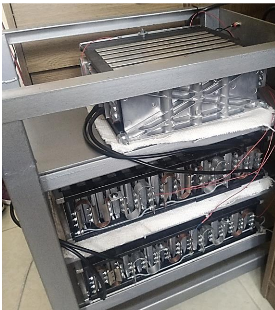
а) акумуляторна батарея ємністю 426 А·год (20,49 кВт·год)
