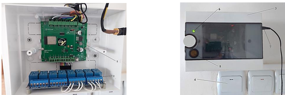
Рисунок 1 – Пульти керування освітленням: 1 – Wi-Fi контролер керування; 2 – реле керування виконавчими механізмами; 3 – лицева сторона пульта; 4 – вимикач 220 В; 5 – вимикач живлення 12 В; 6 – світлодіодний індикатор живлення; 7 – живлення 12 В
