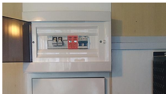
в) блок захисту електростанції
