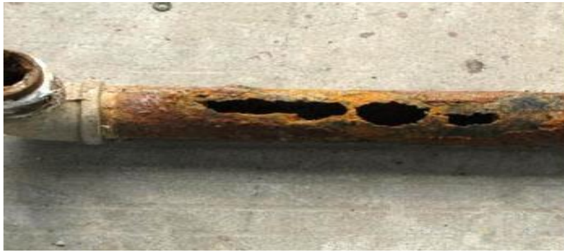
Рисунок 5.6 – Фрагмент трубопроводу гарячого водопостачання після 4 років експлуатації
