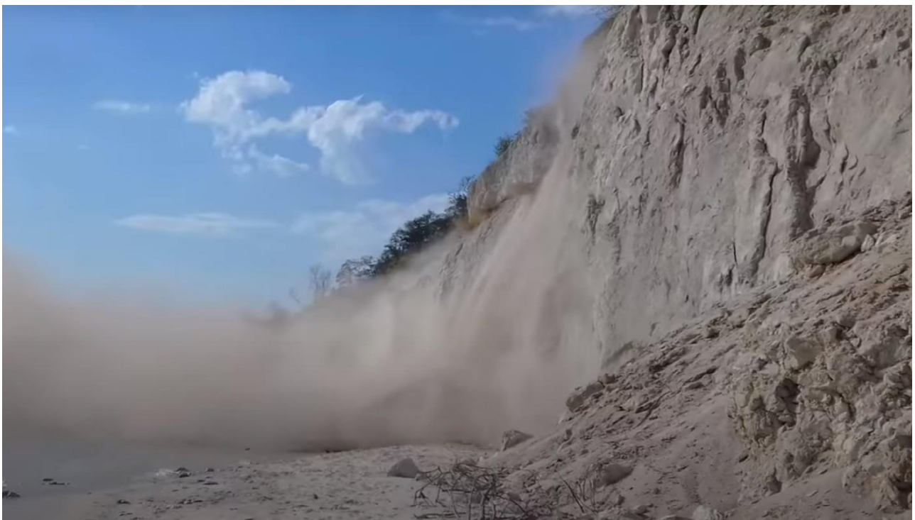
Рисунок 22 – Руйнування берегового укосу Кременчуцького водосховища
