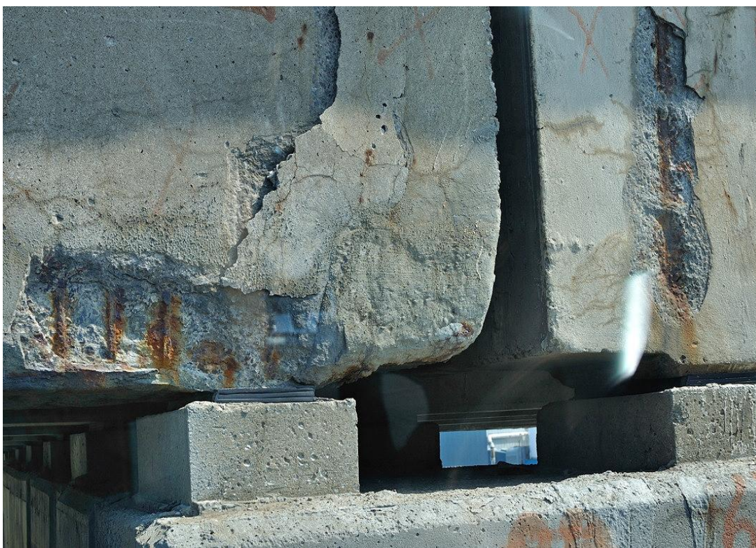
Рисунок 3.13 – Руйнування залізобетонних конструкцій у результаті корозії ( http://www.myhomemontreal.com/content/2/207/ )
