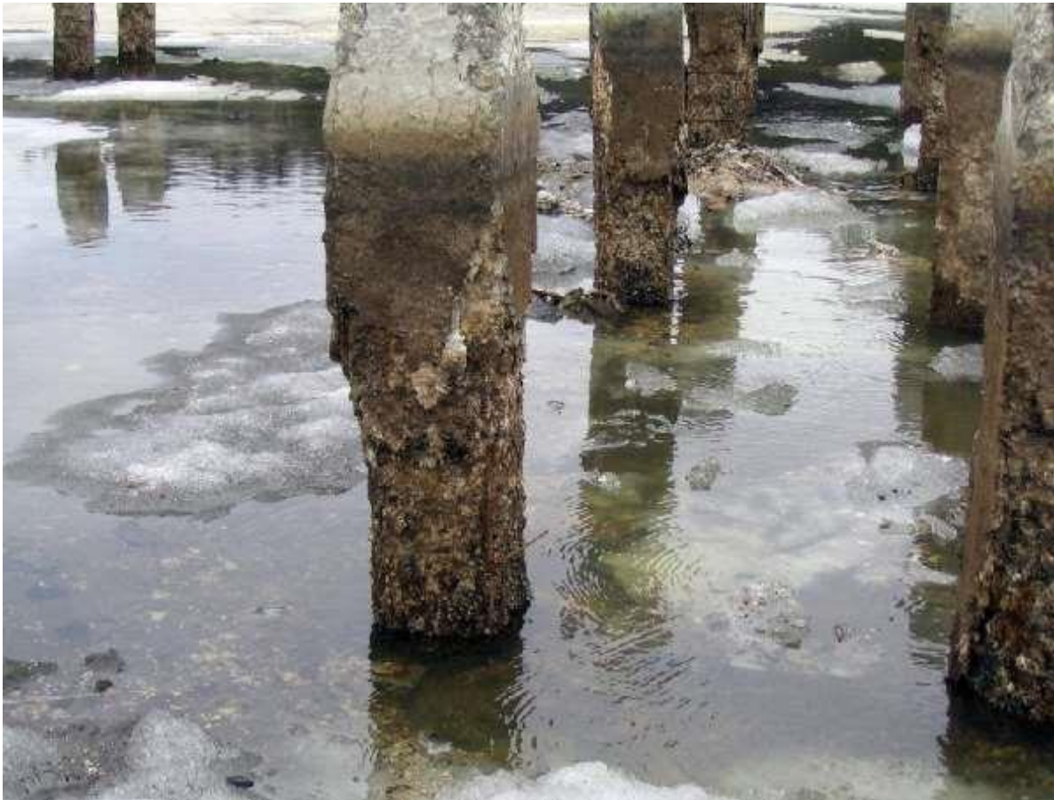
Рисунок 3.12 – Руїнування залізобетонних опор моста через вплив м'яких талих вод ( https://beton-house.com/rabota/zashhita/korroziya-betona-1033:// )
