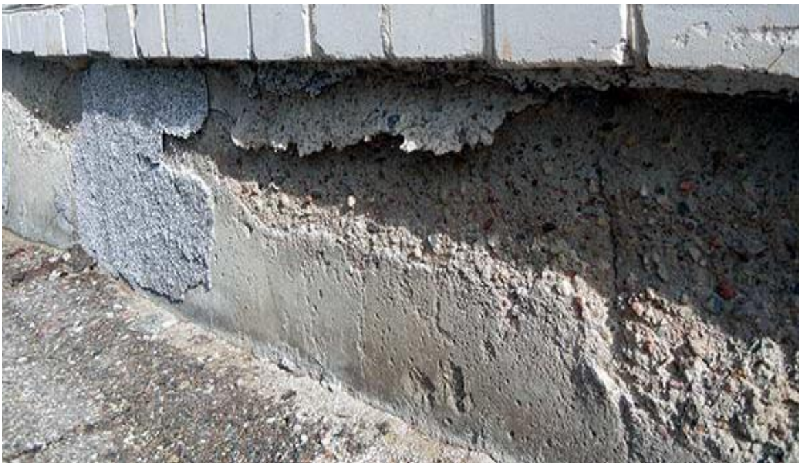
Рисунок 4.11 – Руйнування бетонного фундаменту завдяки капілярній воді ( http://steuler-kch-russia.com/primery-rabot.html?example_start=5 )
