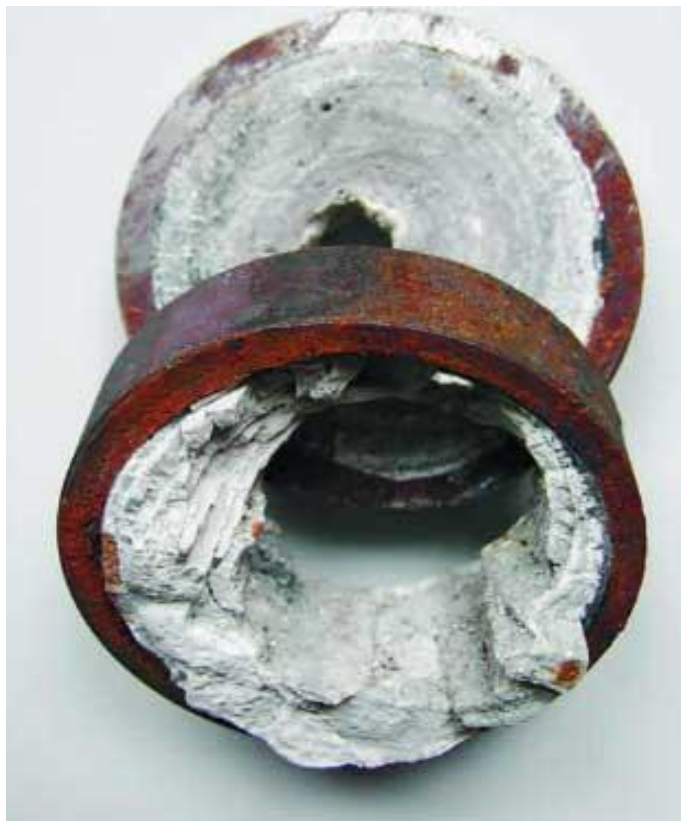
Рисунок 3.3 – Труби опалювальної системи, забиті відкладеннями солей жорсткості води ( http://interesko.info/podrobnee-pro-zhyostkost-vody/ )
