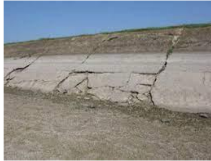
Рисунок 4.18 – Руйнування облицювання зі залізобетонних плит за відсутності заплечиків
