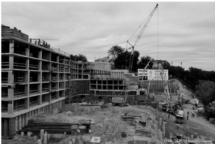
Рис 1. Інженерна підготовка території для будівництва багатоповерхового житлового комплексу з напівпідземним паркінгом в Печерському районі м. Києва
