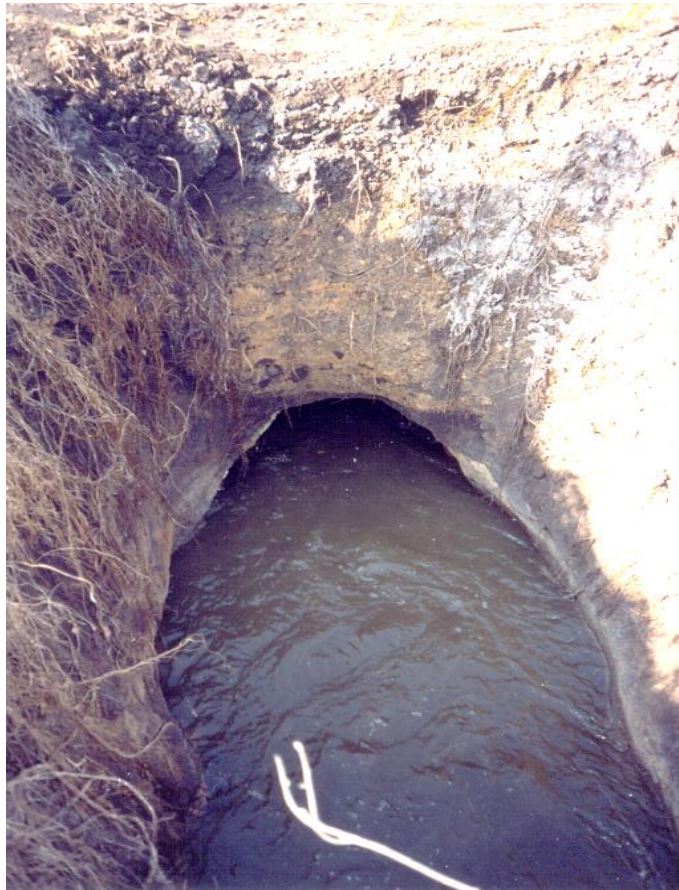
Рисунок 1.2 – Орджонікідзевський колектор зі зруйнованою внаслідок корозії склепінною частиною
