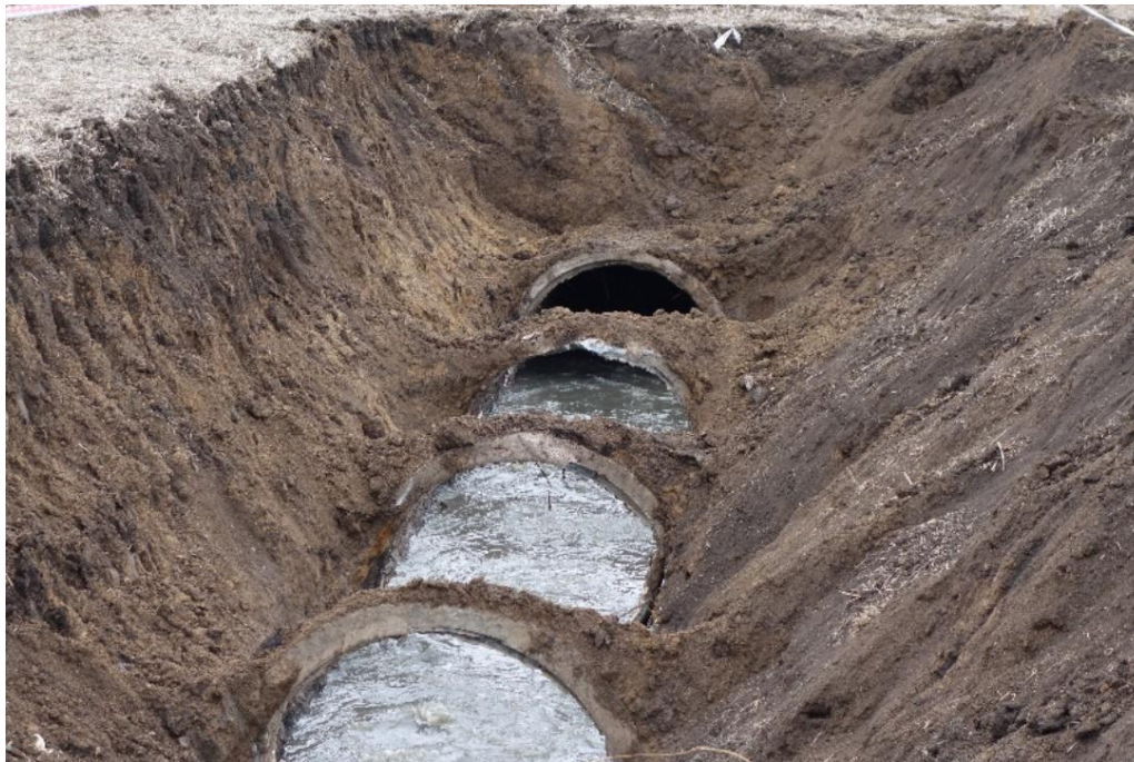
Рисунок 2.1 – Зруйнована склепінчаста частина колектору
