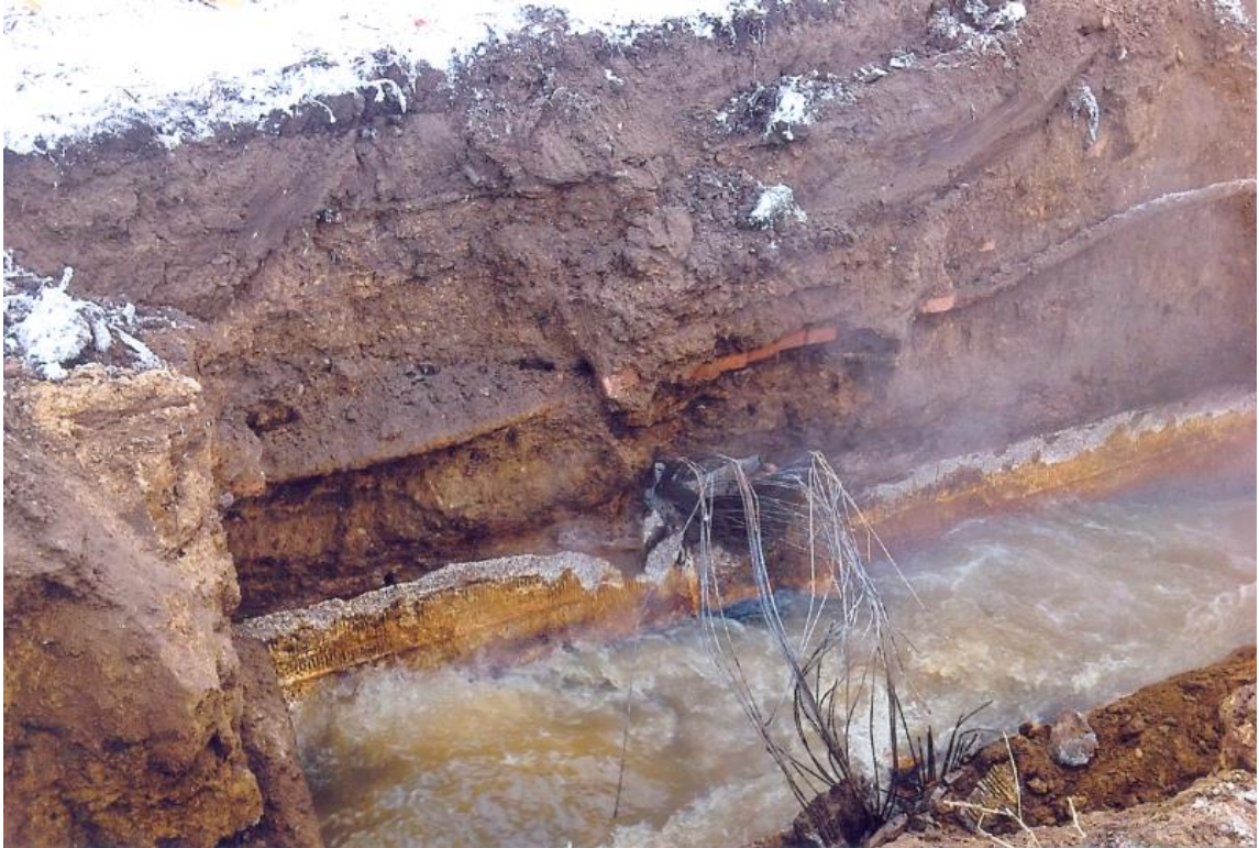
Рисунок 2.3 – Зруйнований колектор в м. Лозова
