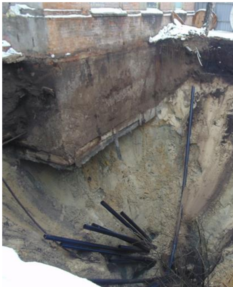
Рисунок 2.2 – Аварійне пошкодження каналізаційного тунелю по вул. Греківській міста Харків
