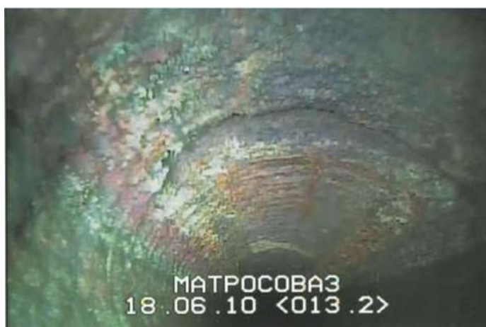
Рисунок 2.4 – Стан каналізаційного тунелю діаметром 2000 мм по вул. Матросова в місті Харків
