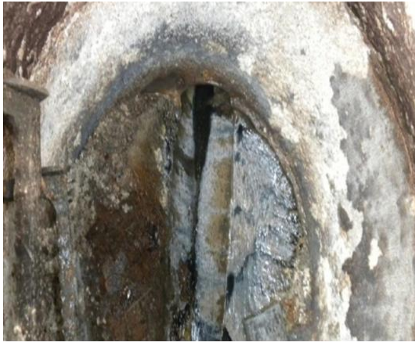
Рисунок 2.9 – Руйнування стін та лоткової частини оглядової шахти після 8 років експлуатації
