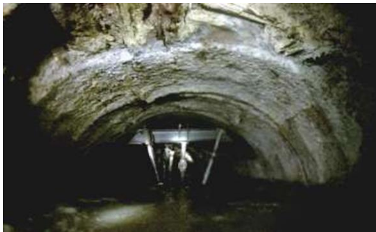
Рисунок 2.3 – Загальний вигляд каналізаційного тунелю ХТЗ зі зруйнованим корозією склепінням
