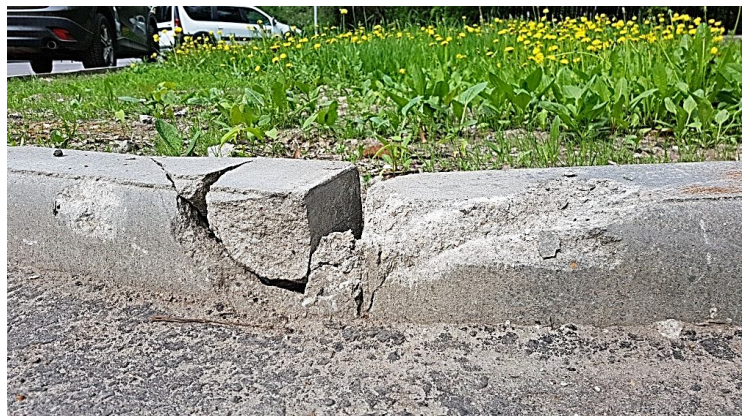
Рисунок 4.57 – Руйнування бортового каменя
