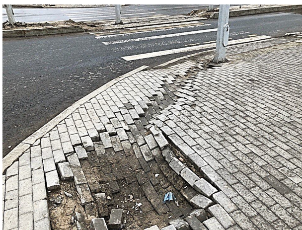
Рисунок 4.52 – Осідання брукованого покриття тротуару
