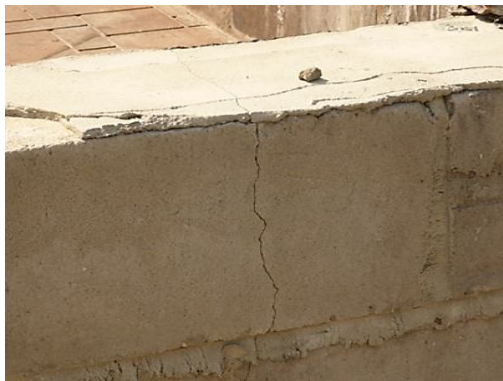
Рисунок 2.7 – Деформація фундаментів – наскрізна тріщина в цокольній частині будинку
