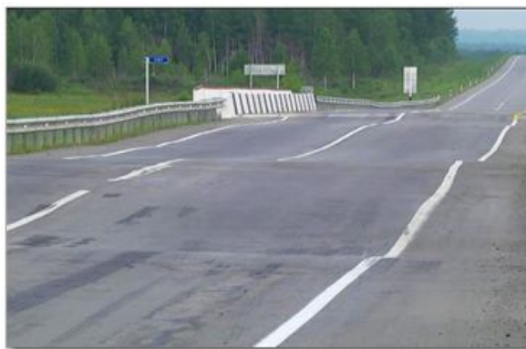
Рисунок 4.42 – Хвилі на асфальтобетонному покритті [22]
