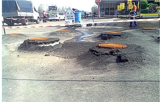
Рисунок 4.58 – Деформації асфальтобетонного покриття навколо люків оглядових колодязів
