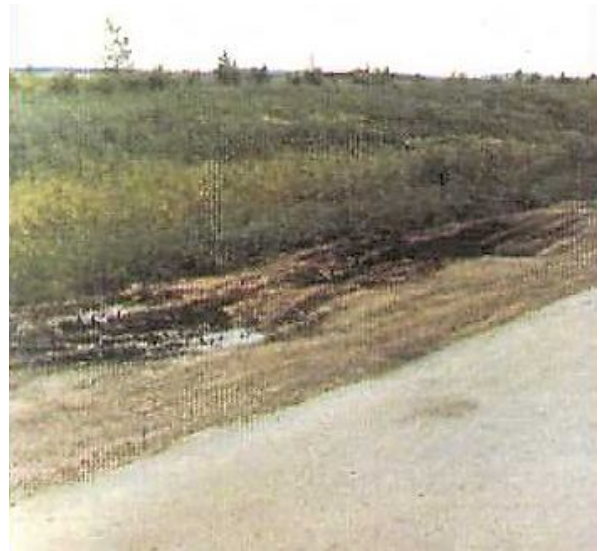
Рисунок 4.37 – Осідання укосів земляного полотна
