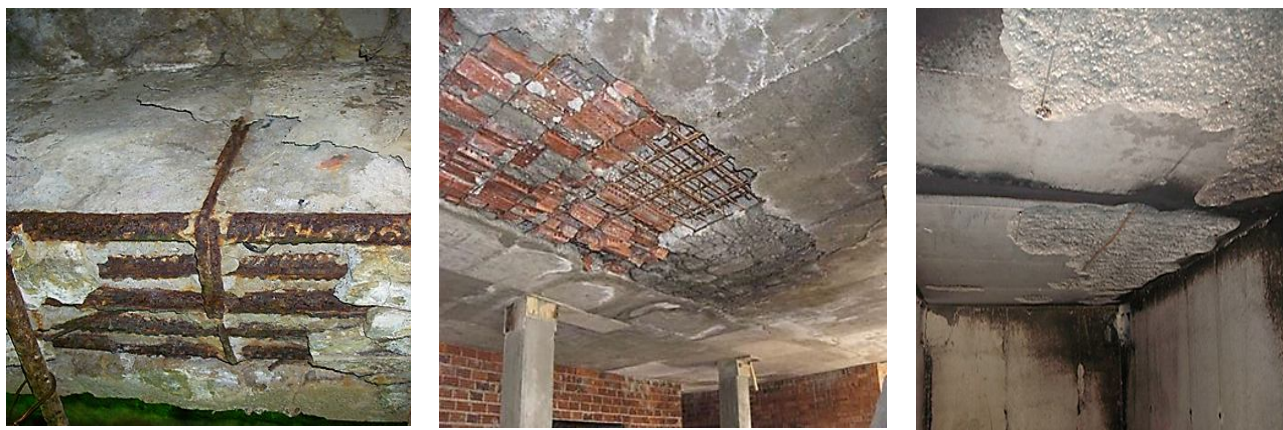
Рисунок 2.18 – Відшарування бетону уздовж арматури
