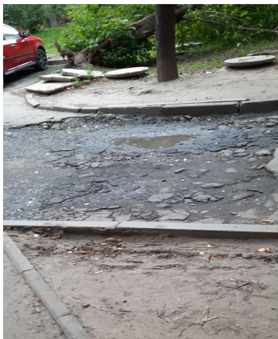
Рисунок 4.45 – Осідання асфальтобетонного покриття внаслідок неправильної заробки розриття
