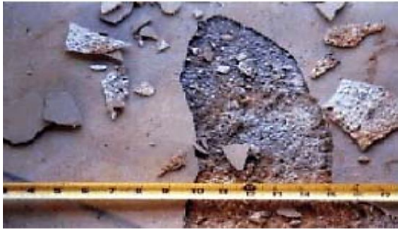
Рисунок 2.5 – Деформація фундаментів – розшарування залізобетонної конструкції [47]
