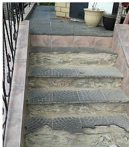
Рисунок 2.31 – Дефекти сходів з керамічною плиткою
