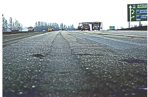
Рисунок 4.41 – Колії на асфальтобетонному покритті
