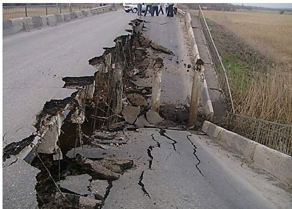
Рисунок 4.43 – Осідання на асфальтобетонному покритті
