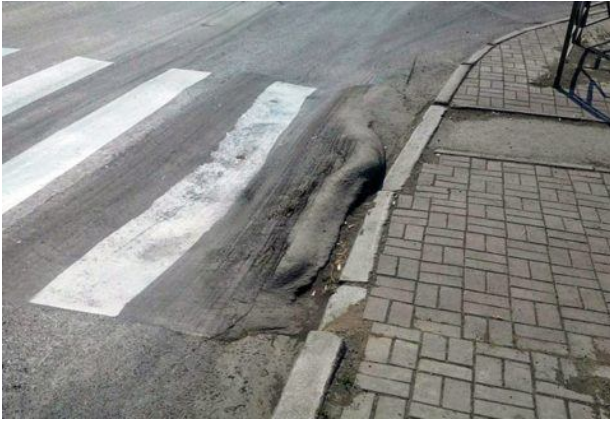
Рисунок 4.47 – Зсуви асфальтобетонного покриття [22]
