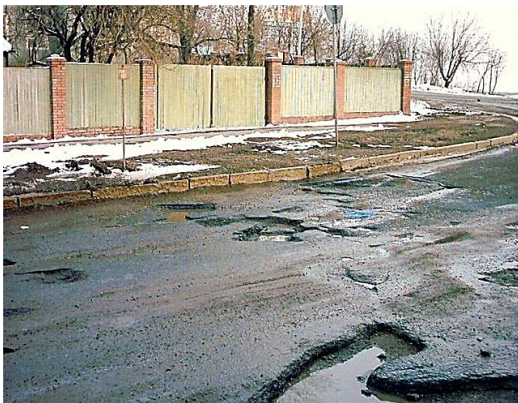
Рисунок 4.40 – Вибоїни на асфальтобетонному покритті
