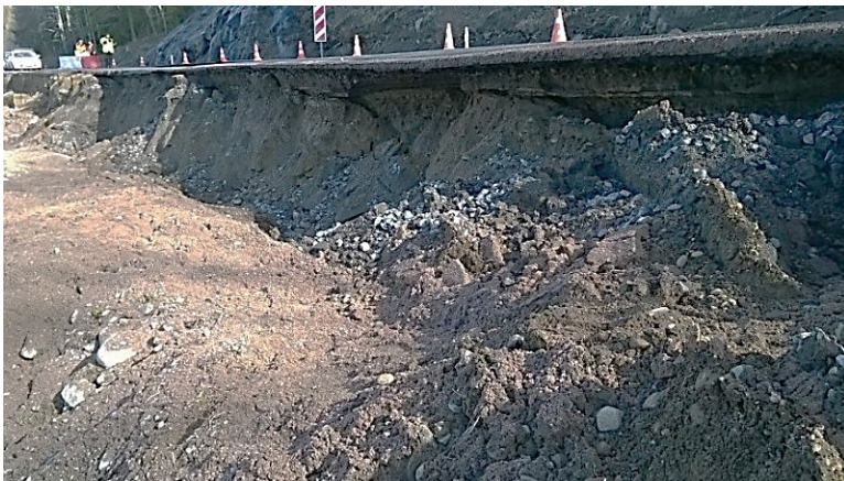
Рисунок 4.38 – Осідання внаслідок незадовільного ущільнення земляного полотна
