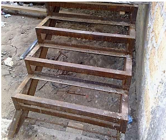
Рисунок 2.28 – Дефекти маршів сходів по металевим косоурам
