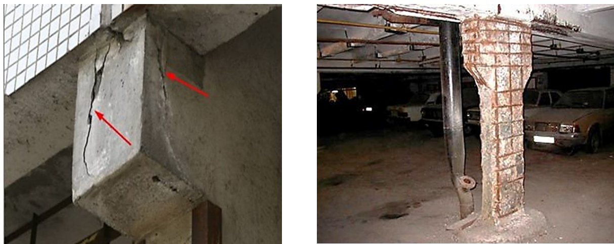
Рисунок 2.17 – Тріщини на опорних ділянках плит
