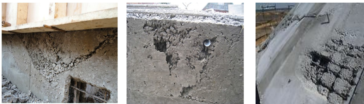
Рисунок 2.4 – Деформація фундаментів – утворення раковин [47]
