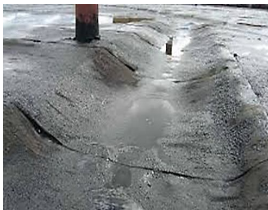
Рисунок 2.21 – Пошкодження рулонної крівлі – протікання
