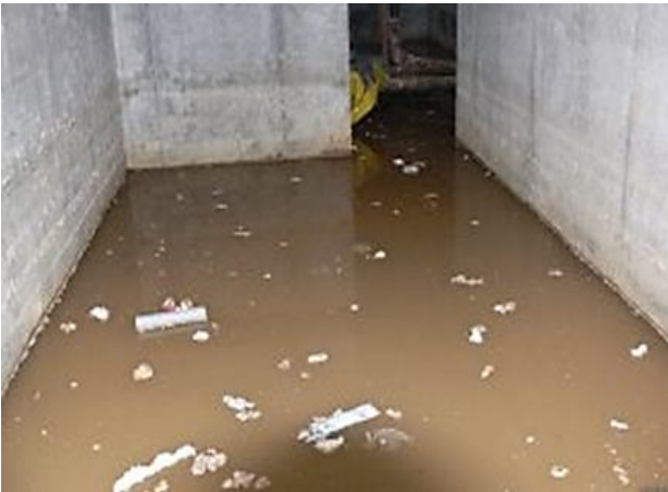
Рисунок 2.9 - Затоплення підвалу ґрунтовими водами внаслідок неправильно виконаної гідроізоляції [36]
