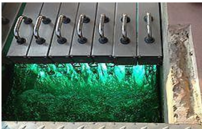
Рисунок 3.77 – Установка ультрафіолетового опромінення
