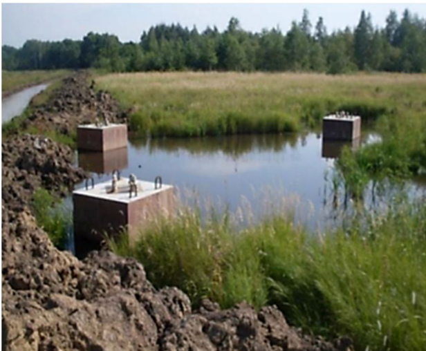
Рисунок 2.10 – Обводнення ділянки забудови [36, 47]
