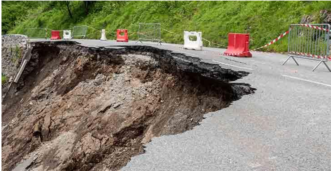
Рисунок 5.2 – Приклад зсувного процесу з пошкодженням конструкції проїжджої частини
