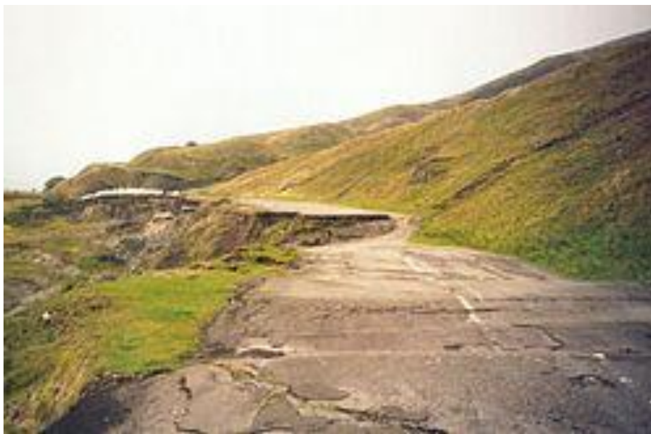
Рисунок 5.5 – Обвальний процес на автошляху
