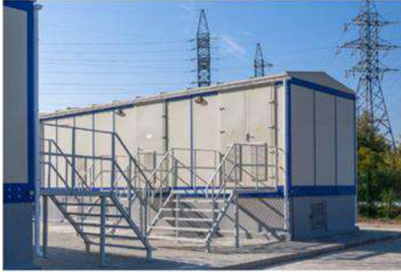
Рисунок 1 – Модульна комплектна тягова підстанція
