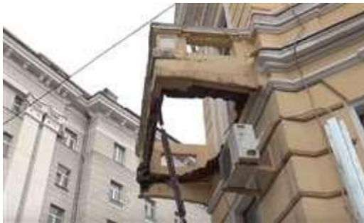
Рисунок 3 – Руйнування балкону в м. Харкові
