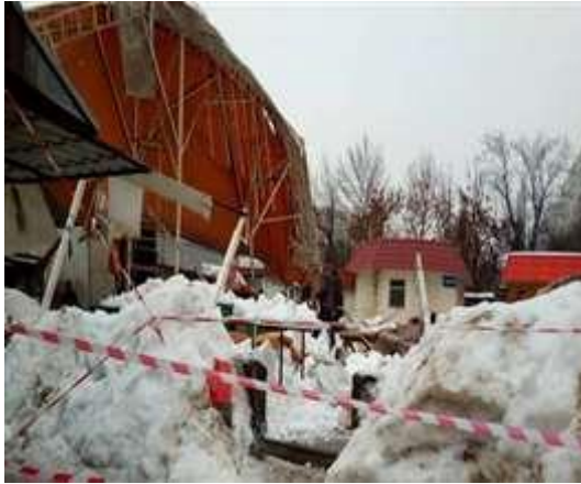
Рисунок. 2 – Обвалення покриття сцени в м.Чугуїв 2019 рік
