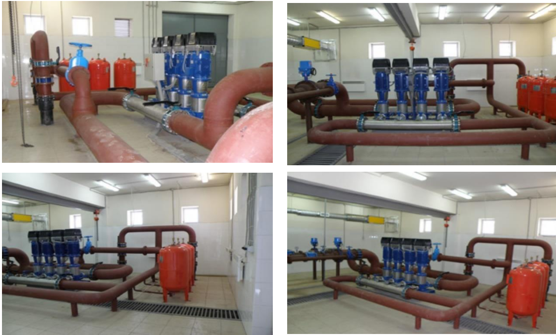
Рисунок 11.1 – Підвищувальна водопровідна насосна станція
