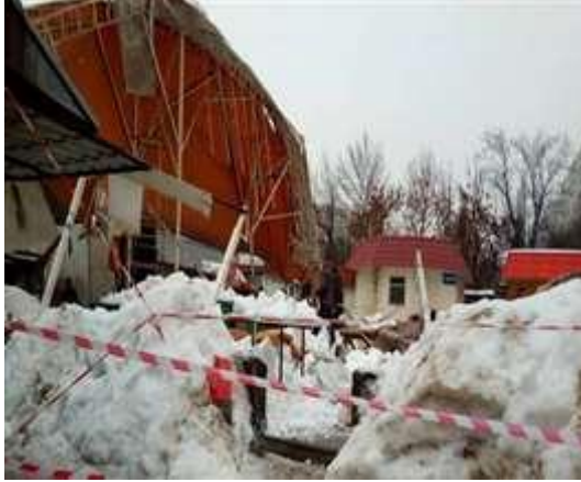
Рисунок 2 – Обвалення покриття сцени в м.Чугуїв 2019 рік
