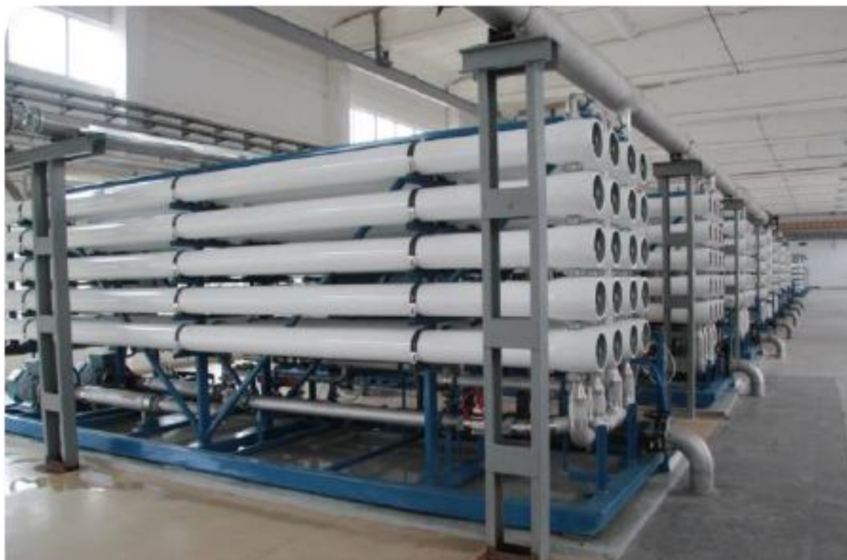
Рисунок 9.17 – Цех підготовлення води в спосіб зворотного осмосу
