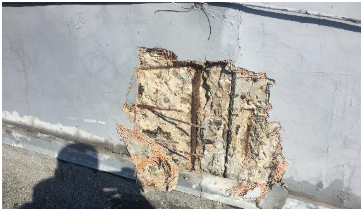
Рис. 2. Стан армування плитної та ребристої частини стінової панелі
