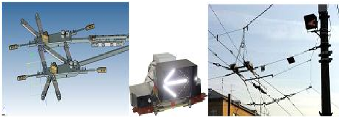
Рисунок 7.10 – Зовнішній вигляд автоматичного стрілочного переводу тролейбуса
