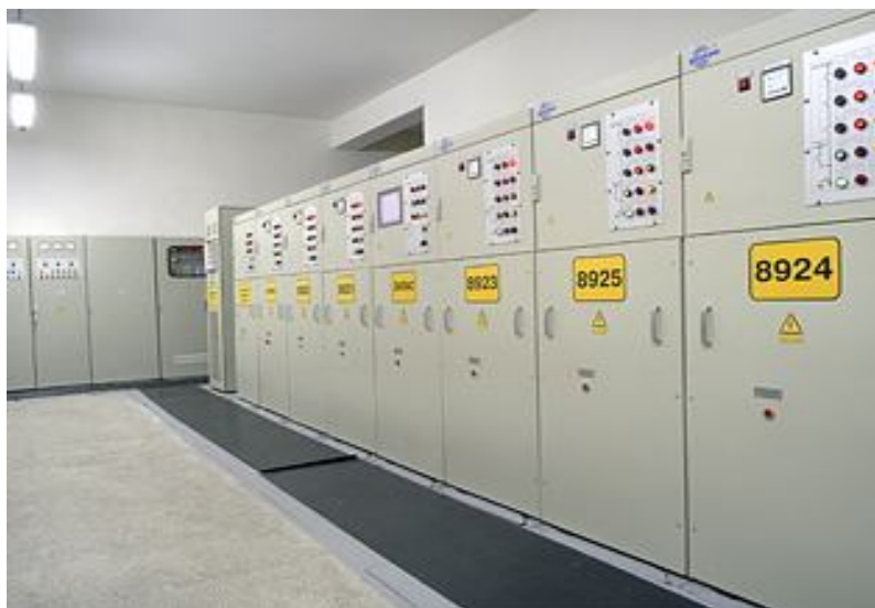
Рисунок 2.8 – Системи керування, моніторингу та захисту тягової підстанції
