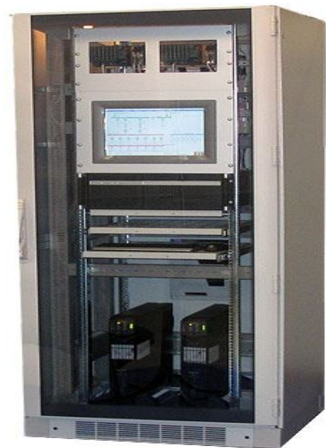
Рисунок 4.10 – Шафа телемеханіки тягової підстанції метрополітену
