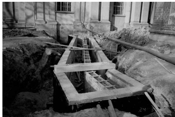
Рис. 8. Канали вентиляції та димовидалення
