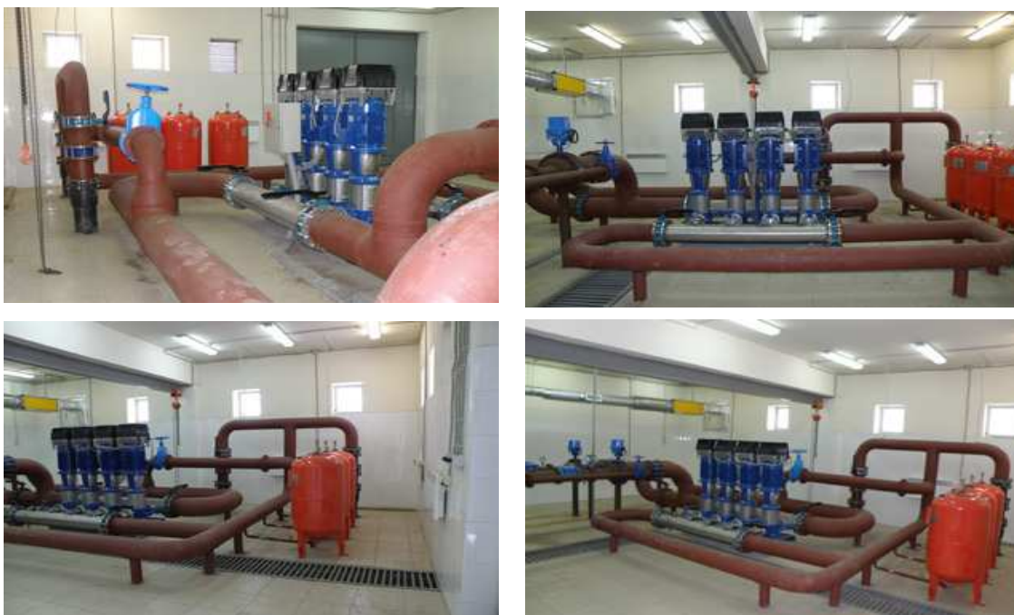
Рисунок 2.26 – Підвищувальна водопровідна насосна станція (м. Санкт-Петербург), 2008 р.
