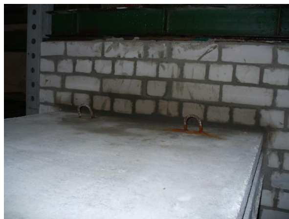
Рис. 11. Верхняя поверхность плиты около заземления после испытания
