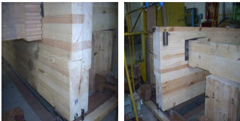
Рис. 7 – Разрушения торцов балки
