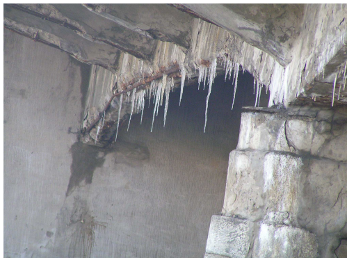
Рисунок 2 – Фильтрация воды на Купеческом мосту
