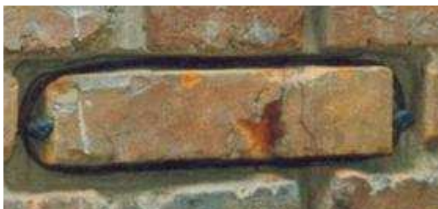
Рис. 4 – Кирпич с трещиной, обжатый проволочным петлевым элементом
