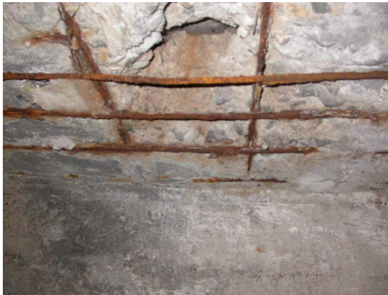
Рис.2 – Фрагмент разрушения нижней поверхности железобетонной плиты
