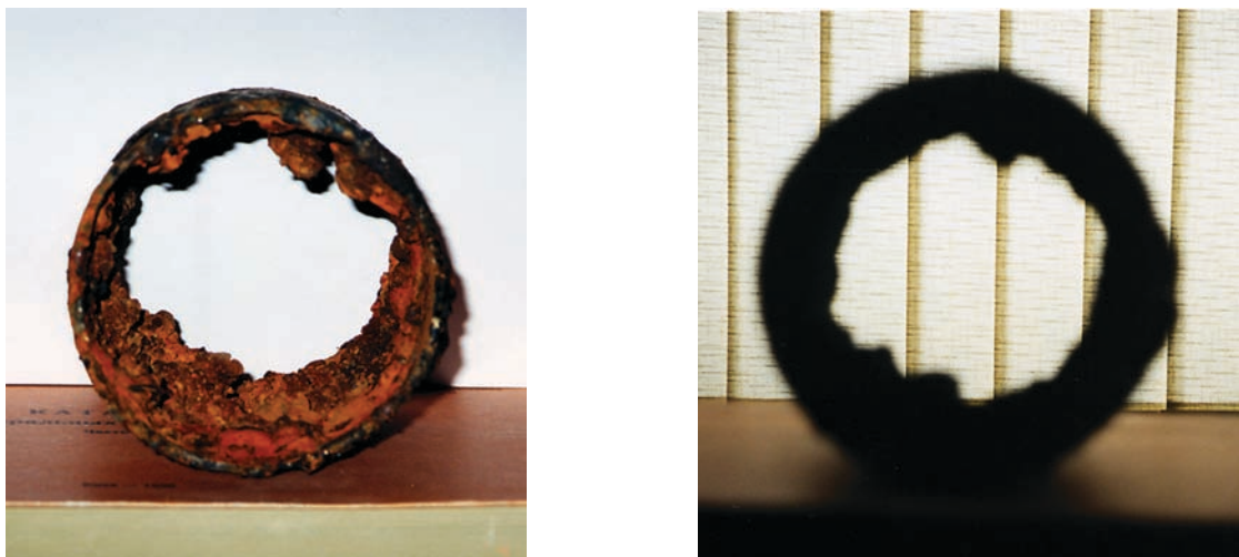
Рис. 5.23. Зарастание ввода ( d = 150 мм) к жилому дому на Алексеевском жилом массиве за 18 лет эксплуатации
