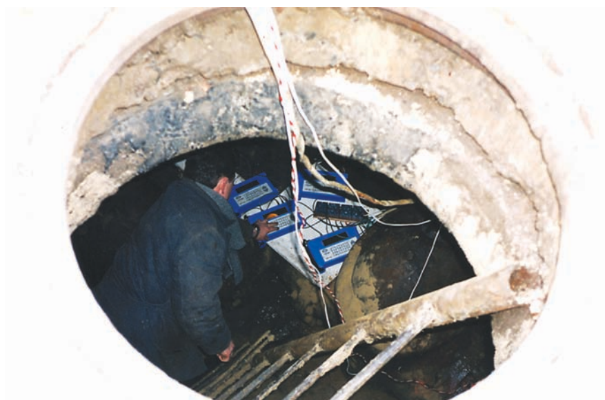
Рис. 2.15. Монтаж приборов учета расхода воды типа UFM 610 р в колодце контрольного пункта по ул. Ахсарова (Харьков)
