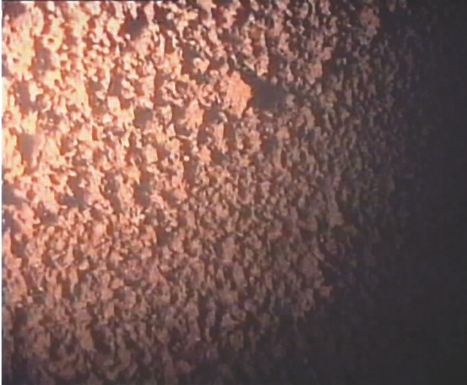
Рис. 3.28. Инкрустация на внутренней поверхности днепровского водовода диаметром 1400 мм (время эксплуатации водовода 16 лет)
