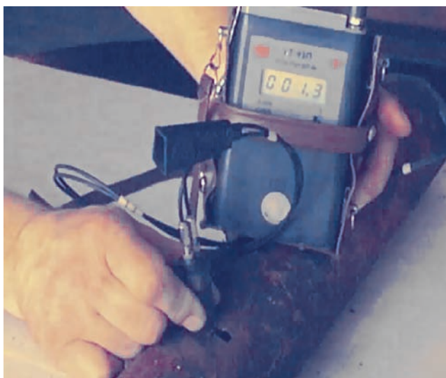
Рис. 6.26. Замеры толщиномером УТ-93П участка трубы, поврежденного язвенной коррозией
