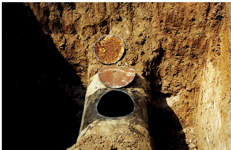
Рис. 2.10. Устройство лаза для контрольных замеров толщины стенок, макрошероховатости и степени зарастания внутренней поверхности водовода
