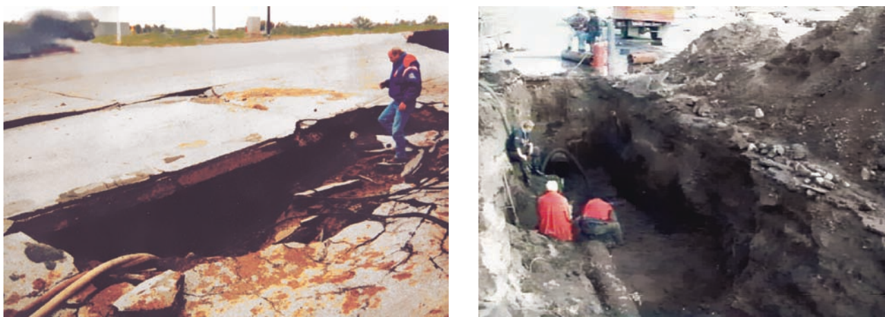
Рис. 6.20. Аварии на водопроводной сети
