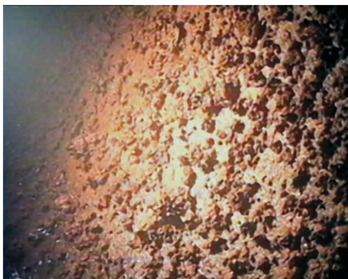
Рис. 3.22. Инкрустация на внутренней поверхности водовода диаметром 1600 мм (время эксплуатации водовода 33 года)
