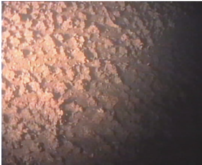
Рис. 3.21. Макрошероховатость внутренней поверхности водовода диаметром 1600 мм (время эксплуатации водовода 33 года)
